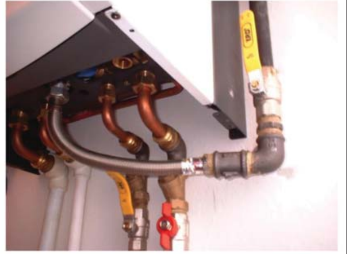
Gaz ve Su Vanalarının Açık olma durumlarını gösteren resimdir.
