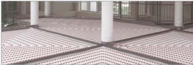
Konut Uygulamaları-Yerden Isıtma / Serinletme
