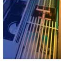
Chilled Beam (Soğuk Kiriş Uygulamaları)
