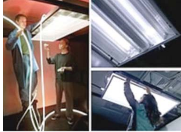
Şekil 6. Konut içersine yerleştirilen aydınlatma lambaları
