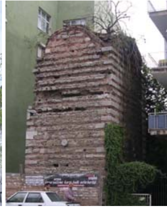
Kadıköy depolu su terazisi
