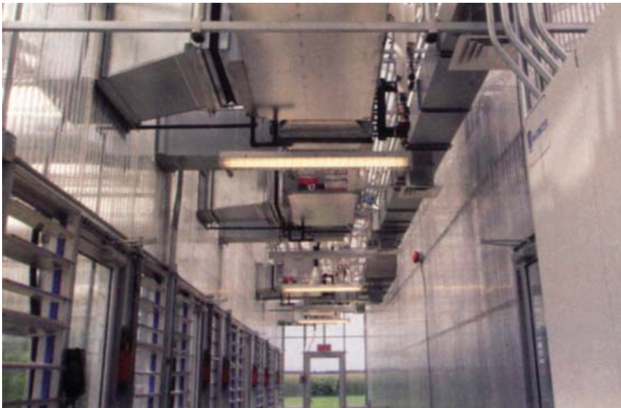
CEROM araştırma merkezi ısı pompaları
