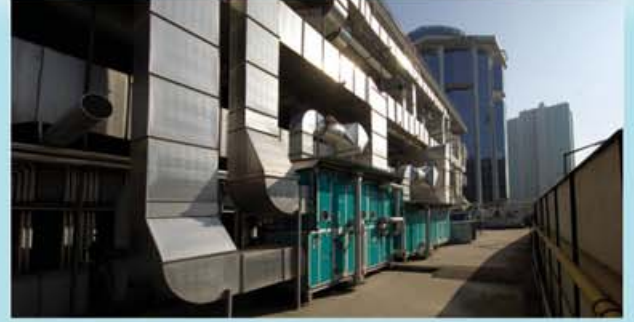
Hijyenik Klima, Temizoda, ve Nanotek Laboratuvar iklimlendirme Sistemleri
