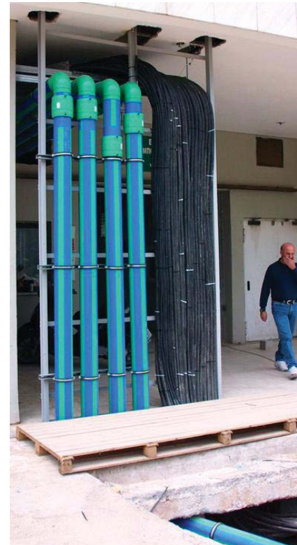
Kolon ve Toplama Hatları
