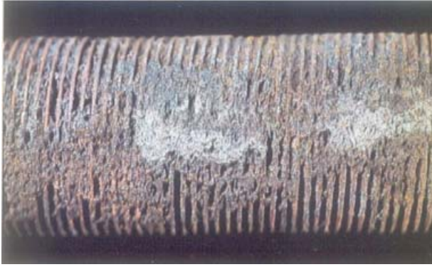
Özellikle kondenser borularının dış yüzeylerinde oluşan korozyon etkisi.
