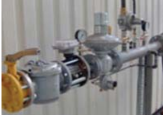
Doğal gaz hattı armatürleri
