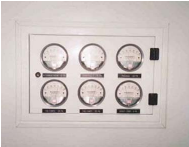
Şekil 5.6. Fark Basınç Manometre Uygulaması
