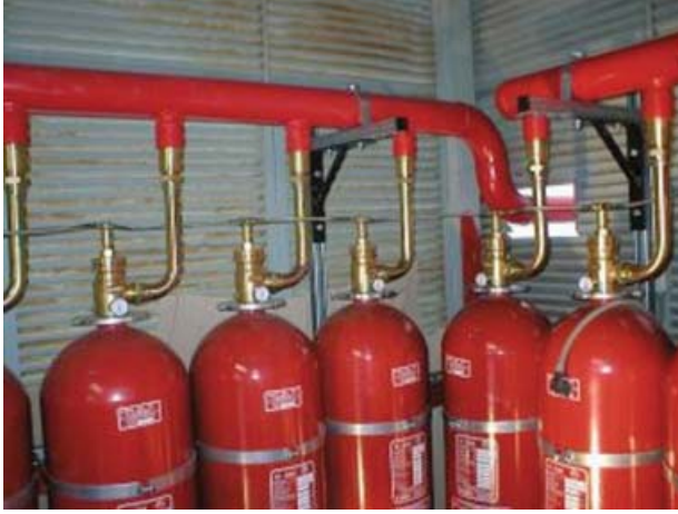
Sistem odası gazlı yangın söndürme sistemi CO 2 tüpleri
