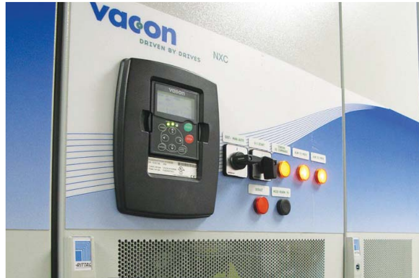
Şekil 2: VACON AC motor sürücü sisteminin panoları, DC çözümüne göre şebekeye yansıyan toplam harmonik oranının %5'in altında kalabilmesi, ve komplike filtrelerle ihtiyaç duymaması gibi çok önemli avantajlar sunuyor.
