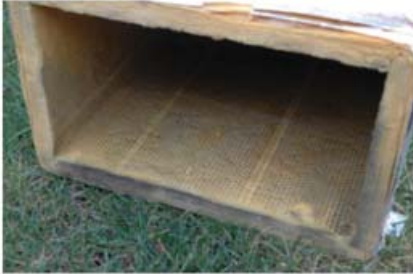
Şekil 4: Hijyenik olmayan havalandırma kanallı örneği[7]
