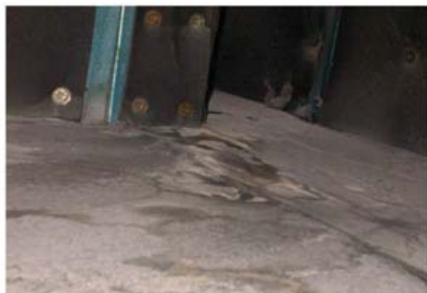
Şekil 6: Hijyenik olmayan havalandırma kanallı örneği[8]
