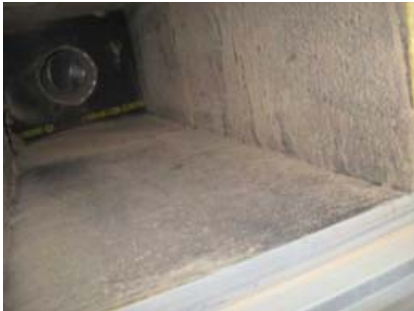
Şekil 5: Hijyenik olmayan havalandırma kanallı örneği[8]
