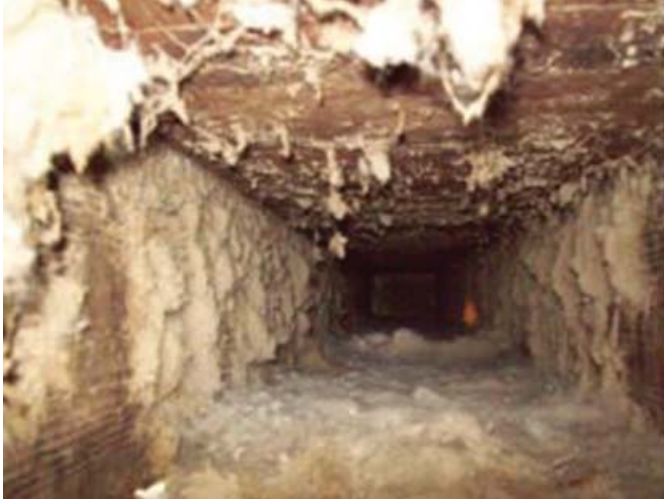
Resim 1: Bakımı yapılmamış bir havalandırma kanalı
